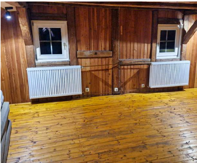
Endlich fertig die Heizungsanlage
